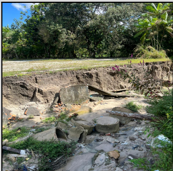
Imagem mostrando trecho com erosão
