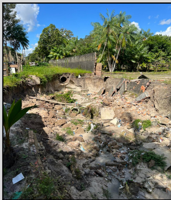
Imagem mostrando parte do muro derrubado pela erosão.
