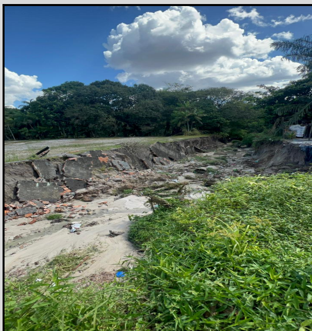
Imagem mostrando área danificada pela erosão.
