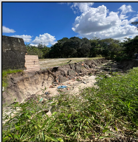
Imagem mostrando parte do muro danificado pela erosão.
