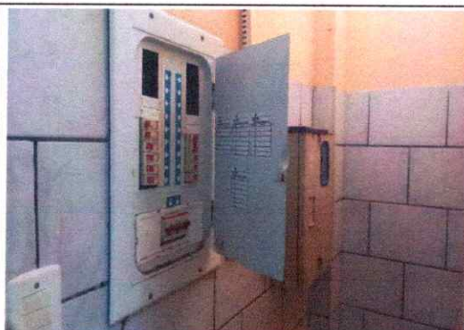
Foto 2: Vista do quadro de distribuição de energia.
