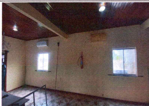
Foto 4: Vista do salão com 04 centrais de ar.
