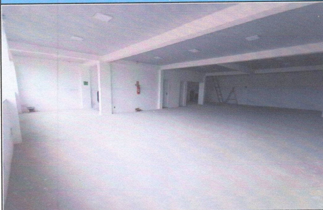
Figura 01: Vista do 2º piso, falta colocar a lajota.
