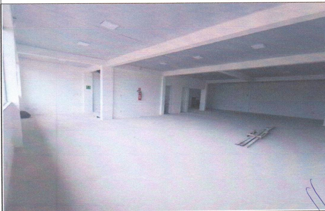
Figura 02: Vista do 5º piso, falta colocar a lajota.
