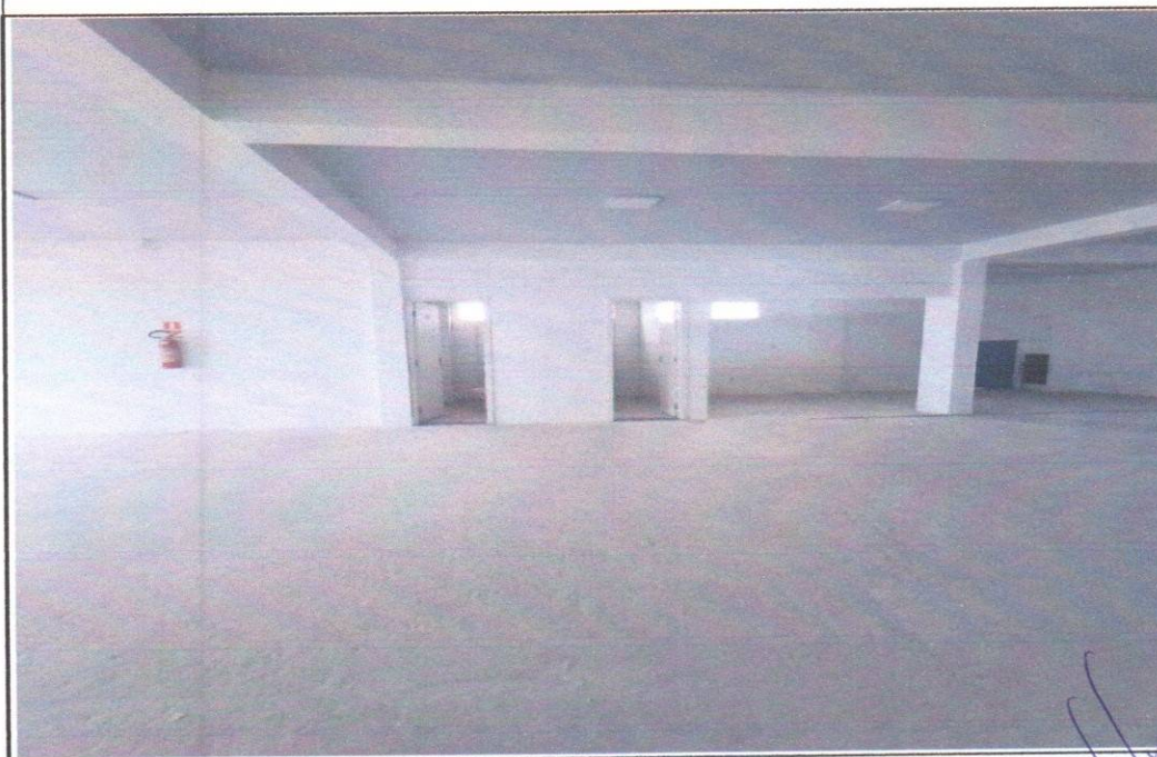
Figura 02: Vista do 3º piso falta, falta colocar a lajota.
