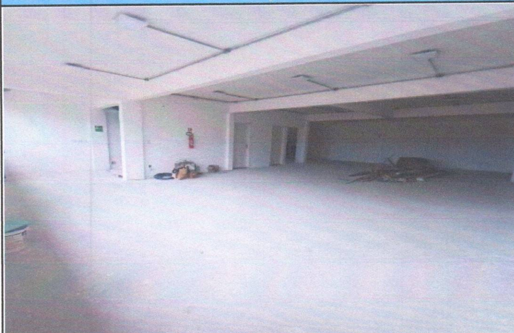
Figura 01: Vista do 4º piso, falta colocar a lajota.
