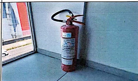
Foto 20: Equipamento de segurança contra incêndio instalado em diversos ambientes do prédio.
